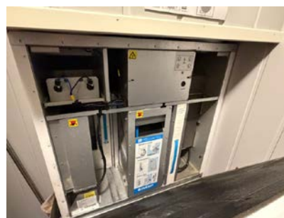
Luftbehandlingsaggregat bak deksel.
