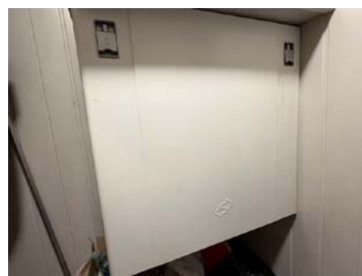
Luftbehandlingsaggregat i bod/teknisk rom.
