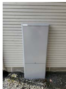
Utvendig målerskap. Målerskap var utilgjenglig for besiktigelse pga. manglende nøkkel. Nøkkel bør fremskaffes.
