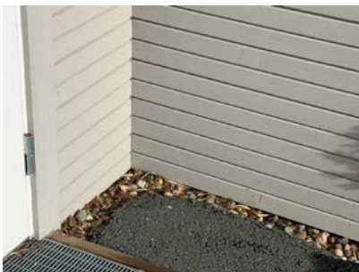
Liten avstand mellom bordkledning - terreng v/ inngangsparti.
