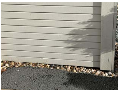
Liten avstand mellom bordkledning - terreng v/ inngangsparti.
