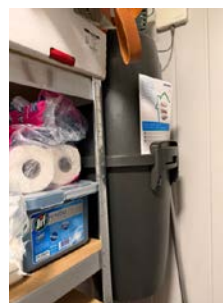
Sentralstøvsuger i bod/teknisk rom.
