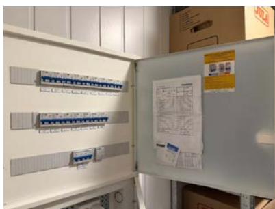
Sikringsskap i bod/teknisk rom.
