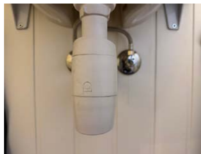
Rørøpplagg under servant.
