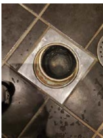
Tettesjiktets tilslutning til sluk - Sluk
