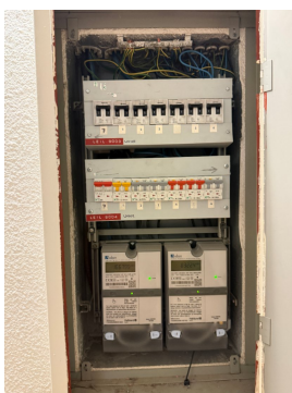
Automatsikringer med skap i felles trappegang.
