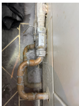
Stoppekraner bak vaskemaskin
