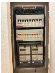
Automatsikringer med skap i felles trappegang.
