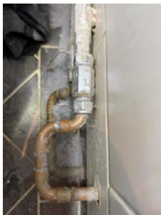
Stoppekraner bak vaskemaskin
