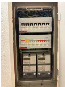
Automatsikringer med skap i felles trappegang.
