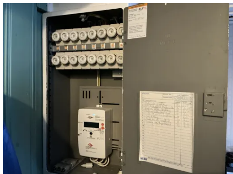
Sikringsskap på bod
