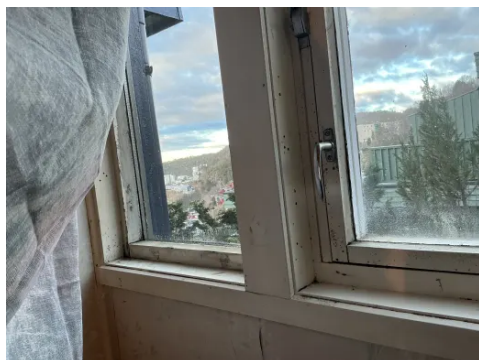
Muggsopp i vinduer på soverom ved entré.
