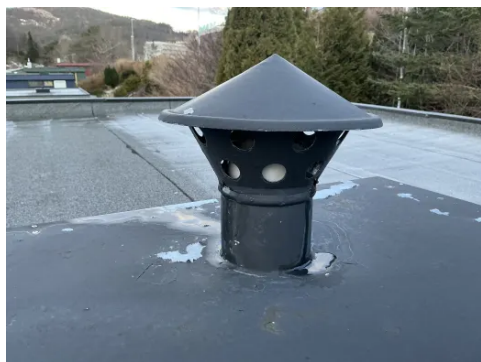
Lufting av avløp
