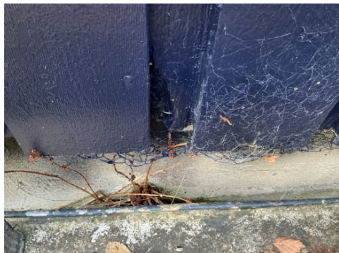
Stedvise mindre råteskader i kledning.
