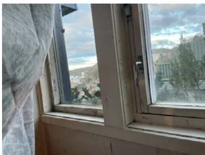
Muggsopp i vinduer på soverom ved entré.
