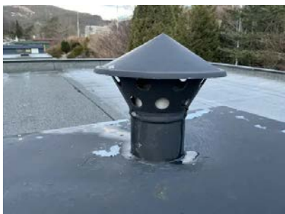
Lufting av avløp
