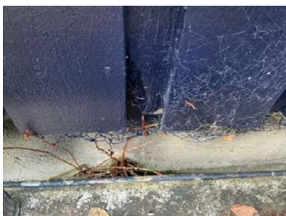
Stedvis mindre råteskader i kledning.
