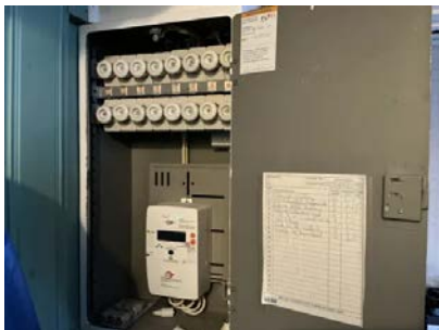
Sikringsskap på bod
