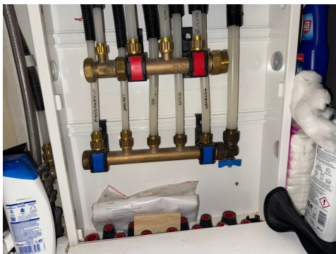
Bad: Rørskap med samlestokker og stoppekraner.
