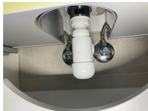
Rørøpplagg i servantskap.
