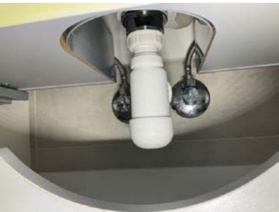
Røropplegg i servantskap.
