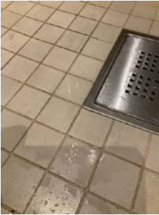
Noe vann ligger igjen ved sluk etter dusjing
