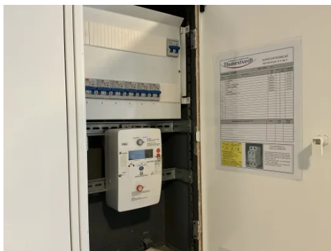
Sikringsskap i felles trappegang.
