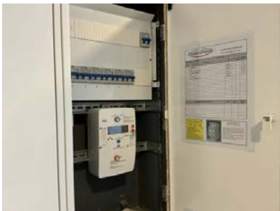
Sikringsskap i felles trappegang.
