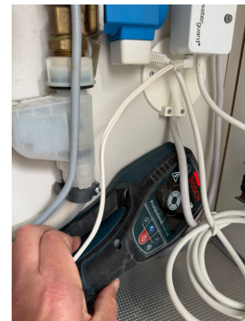
Ikke forsvarlig og borre i kjøkkenvegg
