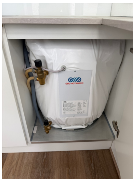
Bereder i kjøkkenbenk med heat injection.
