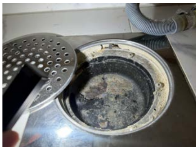
Hjelpestluk under servantskap
