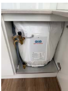
Bereder i kjøkkenbenk med heat injection.
