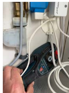
Ikke forsvarlig og borre i kjøkkenvegg
