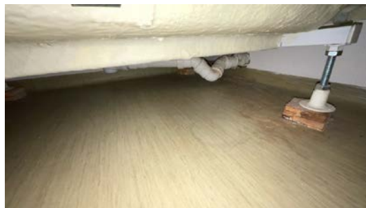
Avløp til dusjkabinett går ut til kjøkkenet.
