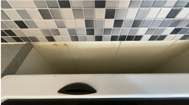
Synlige avvik på vegg ved komfyr.
