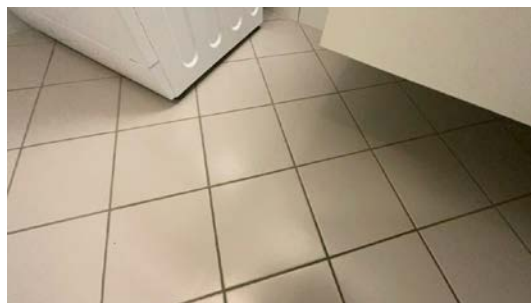
Synlige sprukket fliser.
