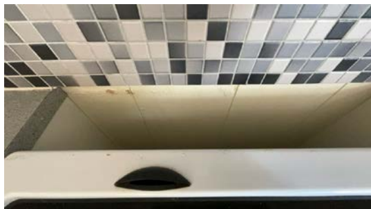
Synlige avvik på vegg ved komfyr.
