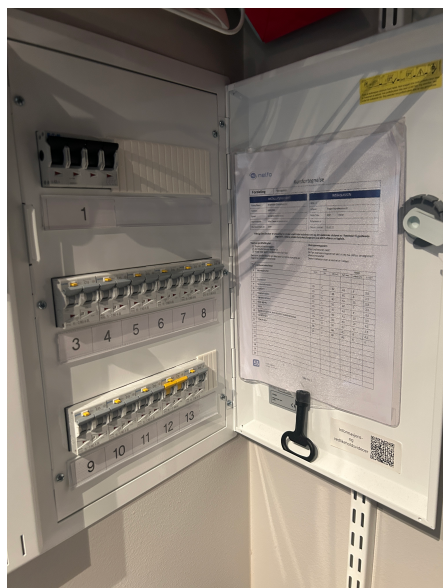
Sikringsskap plassert i gang.
