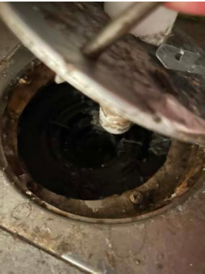
Sluk på bad i U.etasje
