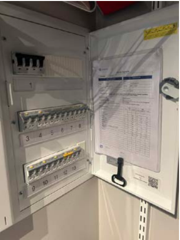
Sikringsskap plassert i gang.
