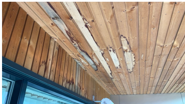
Skader i himling på balkong.
