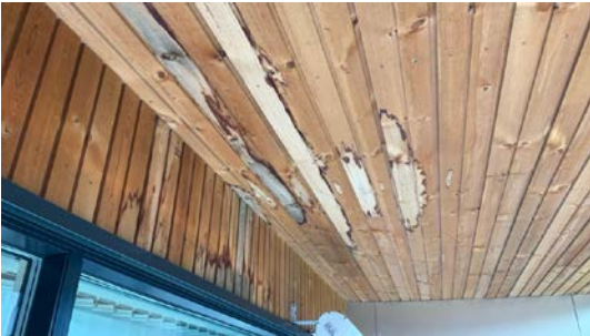
Skader i himling på balkong.
