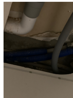
Det mangler tettemuffer for varmerør i kjøkken
