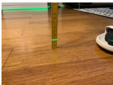
Det er påvist skjevheter i gulv
