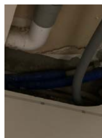
Det mangler tettemuffer for varmerør i kjøkken
