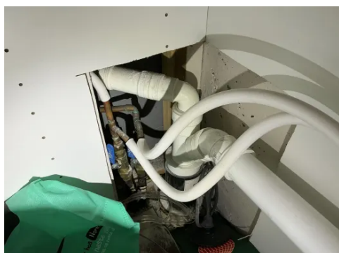
Stoppekran under kjøkkenbenk.
