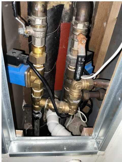
Stoppekran fra toalettrom.
