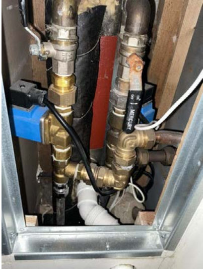
Stoppekran fra toalettrom.
