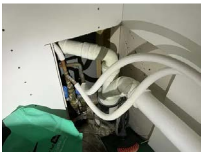
Stoppekran under kjøkkenbenk.
