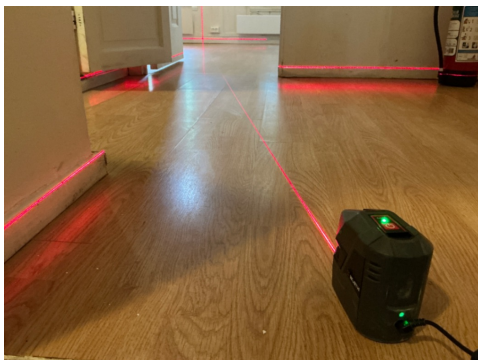
Nivellering kjøkken, gang og soverom, avvik ca. 10-20 mm
