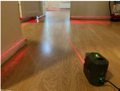
Nivellering kjøkken, gang of soverom, avvik ca. 10-20 mm
