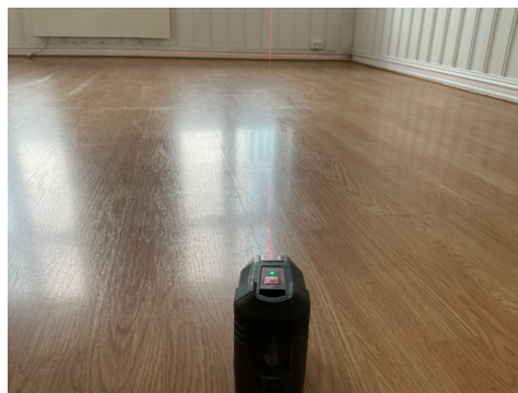
Nivellering soverom, avvik ca. 10-20 mm
