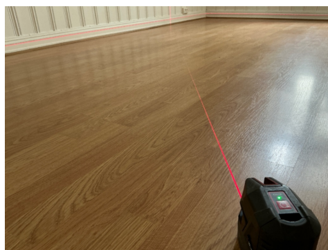
Nivellering stue/kjøkken, avvik ca. 10-20 mm
