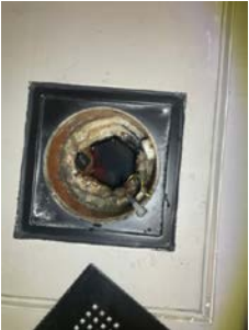
Plastsluk med behov for rengjøring.
