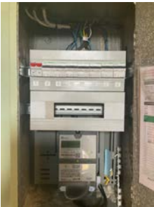
Elskap, plassert i felles trappegang.
