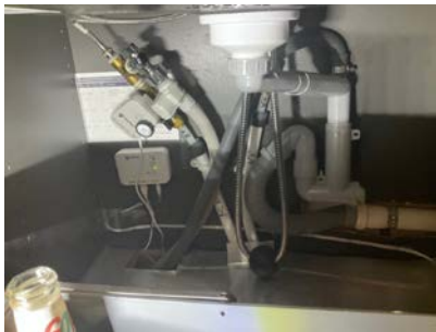
Røropplegg i kjøkkenbenk.
