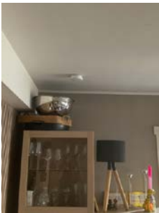
Røykvarsler stue med tilknytning til borettslaget.
