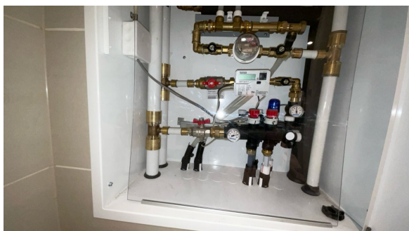
varmefordeling i skap
