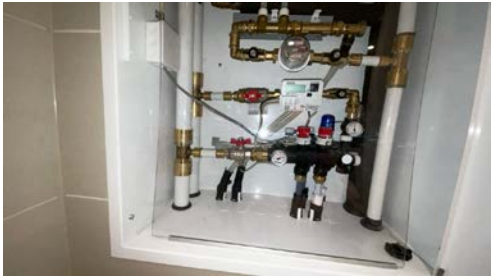
varmefordeling i skap
