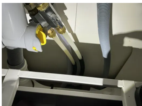
Mangler mansjetter på vannrør.
