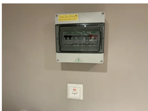
Eget sikringsskap til u.etg.
