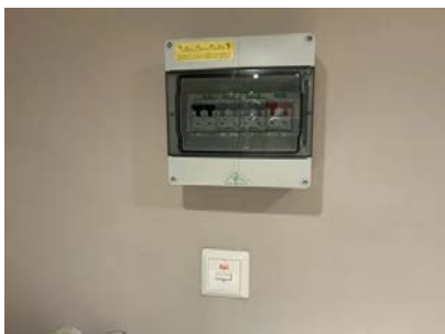
Eget sikringskap til u.etg.
