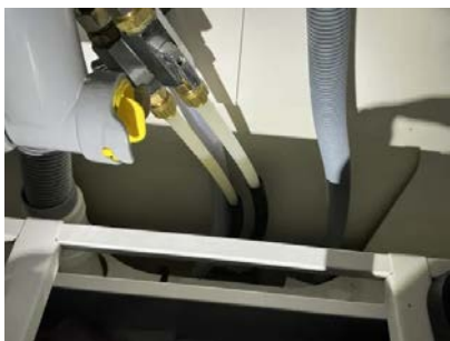
Mangler mansjetter på vannrør.
