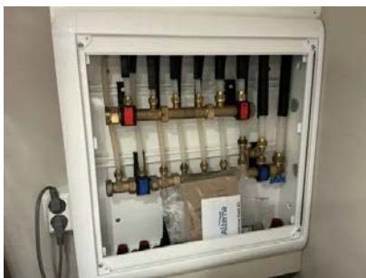
Fordelerskap til «rør i rør» vannforsyning på vaskerom.
