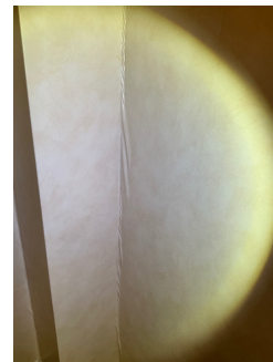
Tapet løsnet fra vegg i våtsonen
