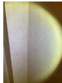
Tapet løsnet fra vegg i våtsonen
