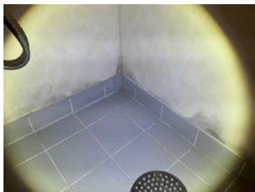
Fuktmerker tapet dusjen
