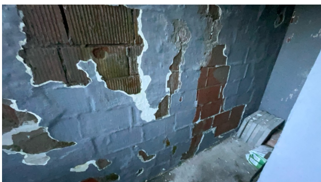
Behov for lokale utbedringer.
