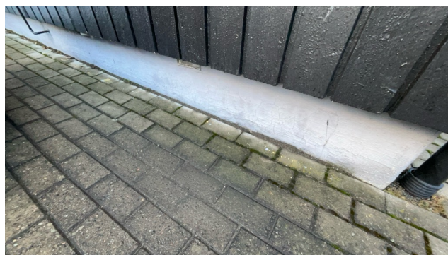
Synlig riss i murpuss.
