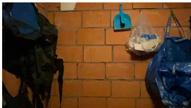
Synlige riss i grunnmur.
