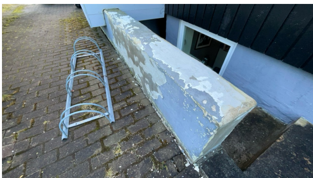
Behov for lokale utbedringer.
