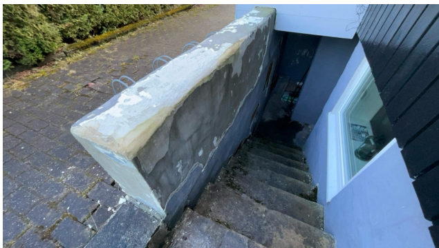
Behov for lokale utbedringer.
