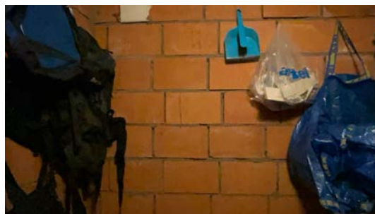
Synlige riss i grunnmur.
