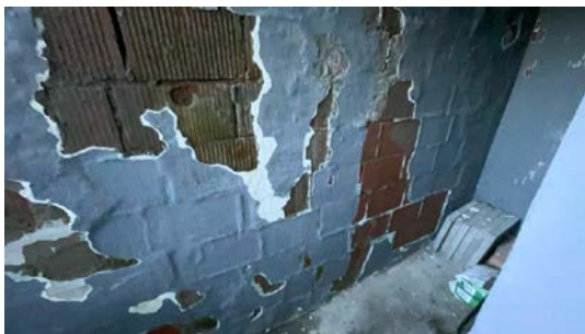
Behov for lokale utbedringer.
