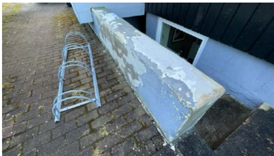
Behov for lokale utbedringer.
