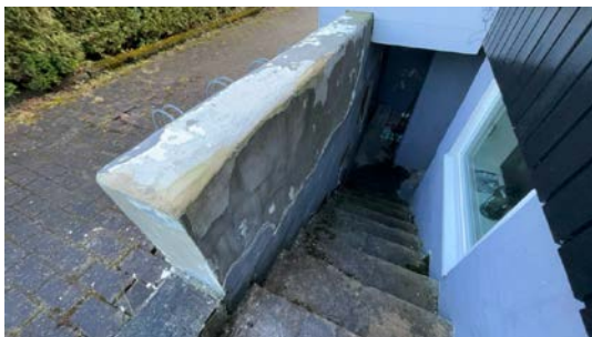
Behov for lokale utbedringer.
