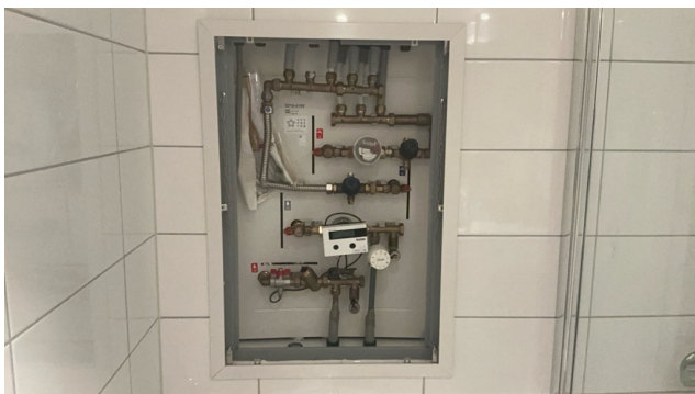
Rørskap på badet.
