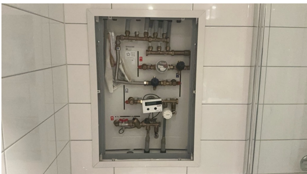
Rørskap på badet.
