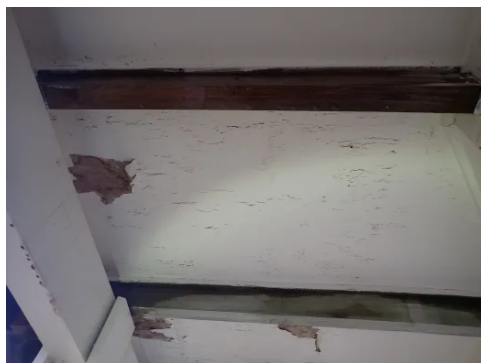
Synlig slitasje på underliggende treplate.
