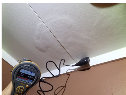
Fuktskade i underliggende himling (innvendig tak).
