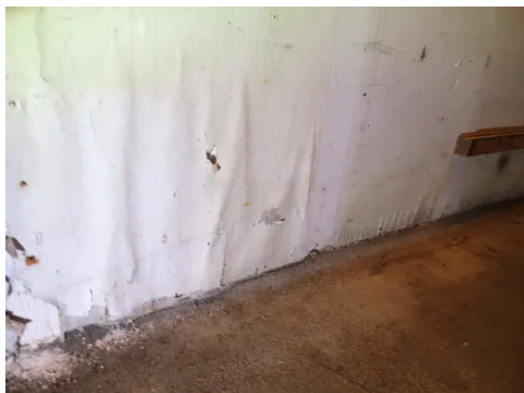
Fuktskadde gipsplater i område ved dør mot garasjeport.
