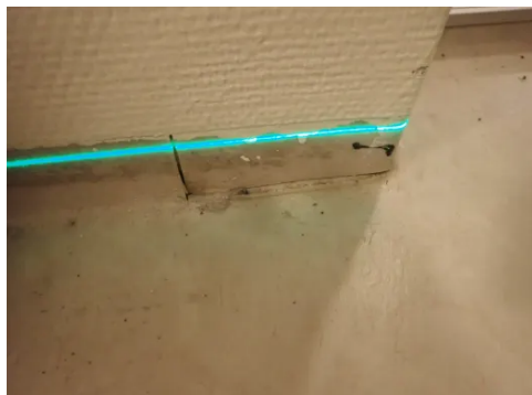
Eksempel på stedvis løsnet skjøt på gulvbelegg.
