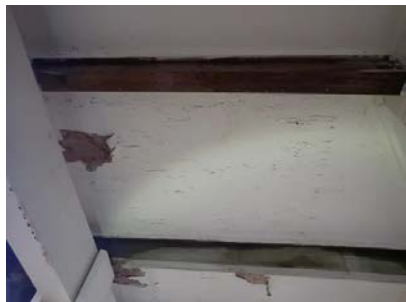
Synlig slitasje på underliggende treplate.
