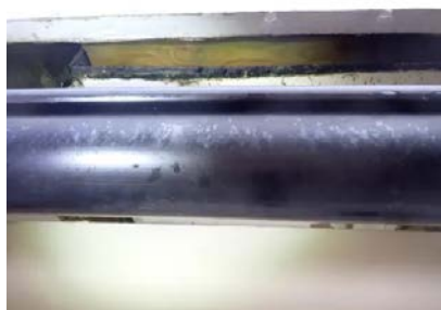
Synlig tekking med papp, det er ikke etablert beslag slik at vann renner til takrenne og underliggende treplate blir utsatt for fuktpåkjenning.
