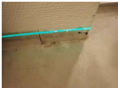
Eksempel på stedvis løsnet skjøt på gulvbelegg.
