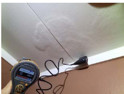
Fuktskade i underliggende himling (innvendig tak).
