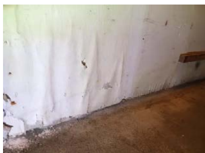
Fuktskadede gipsplater i område ved dør mot garasjeport.
