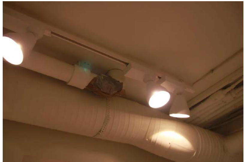
Lekkasjepunkter på avløpsrør inne i Dressmann. Lekkasje er utbedret, men rørisolasjon må reetableres så dette ser ordentlig ut.
