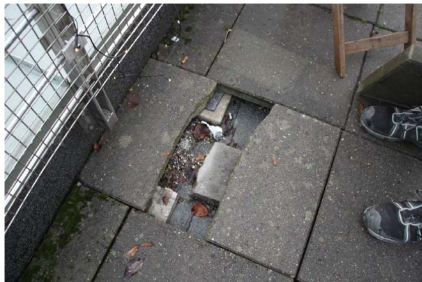
Knekt betonghelle byttes ut. Merke heller som er plassert over sluk til taknedløp så disse kan renses jevnlig (vaktmester).
