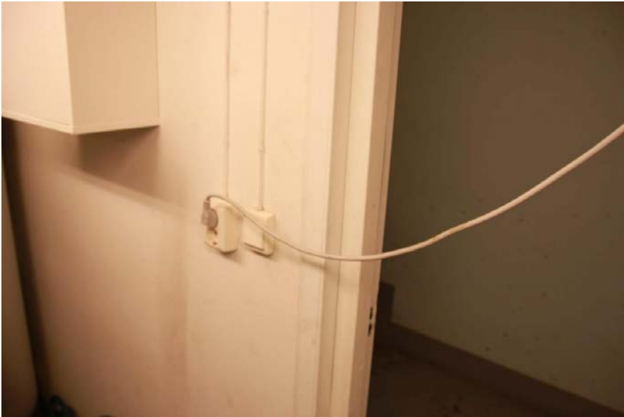
Elektrisk ledning fra varmtvannsbereder henger foran døren. Dette må kobles permanent og festes forskriftsmessig til veggen. (Brannfare).
