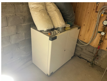
Aggregat plassert på teknisk rom
