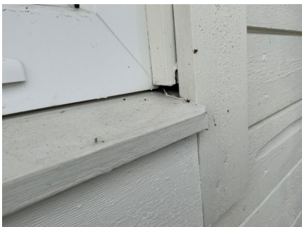
Manglende oppbrett på utvendig beslag
