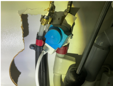
Manglende tettmuffe rundt varerør
