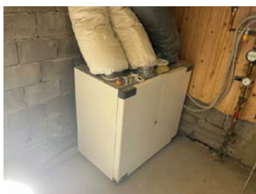
Aggregat plassert på teknisk rom
