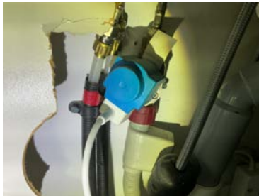
Manglende tettemuffe rundt varerør
