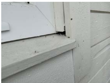
Manglende oppbrett på utvendig beslag
