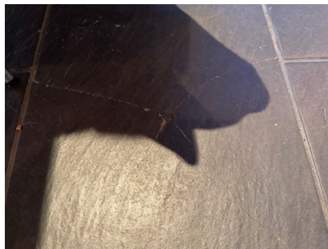
Sprekk i gulvflis.
