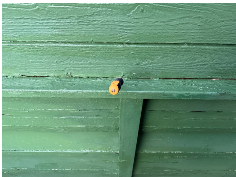
Råte i kledningsbord på levegg.
