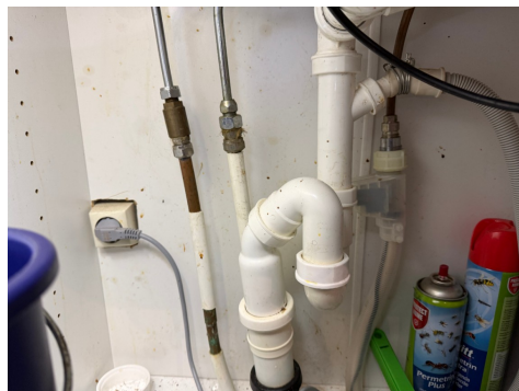
Rørøpplagg under vask.
