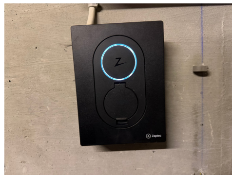
El. bil ladestasjon i garasje.
