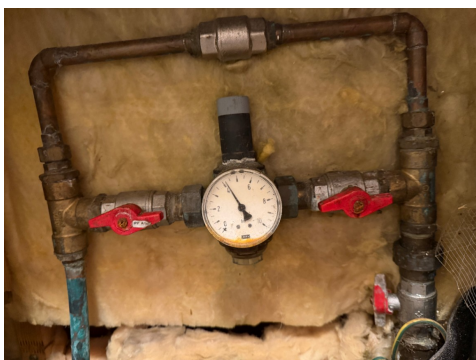
Stoppekraner på vaskerom.
