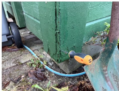
Råte i hjørnebord.
