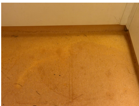
Misfarging i våtromsbelegg.
