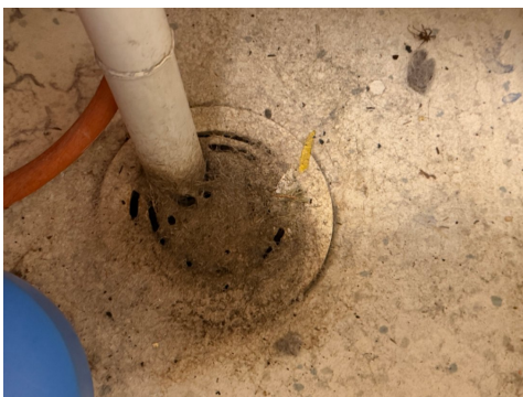
Eldre plastsluk i gulv.
