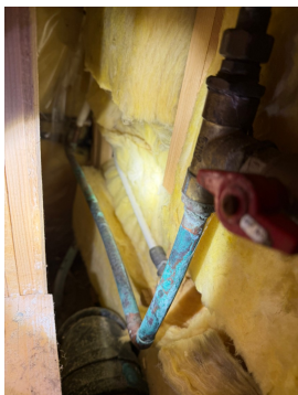
Irr på vannrør v/ stoppekraner.
