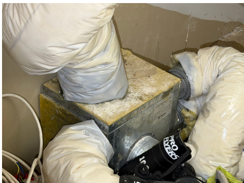
Ventilasjonsaggregat i bod i loft-etg.
