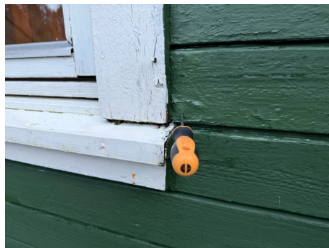
Råte i kledningsbord.
