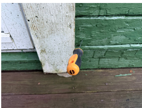
Råte i kledningsbord.
