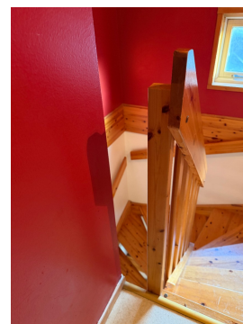
Det mangler rekkverkspile v/ trapp i loft-etg. Bør utbedres.
