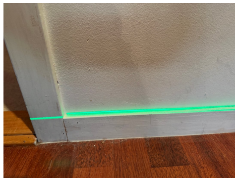
Bilder viser skjevheter i gulv i loftstue.
