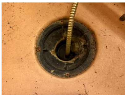
Eldre plastsluk i gulv.
