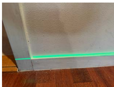
Bilder viser skjevheter i gulv i loftstue.
