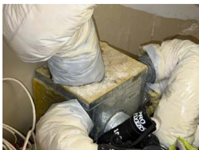
Ventilasjonsaggregat i bod i loft-etg.
