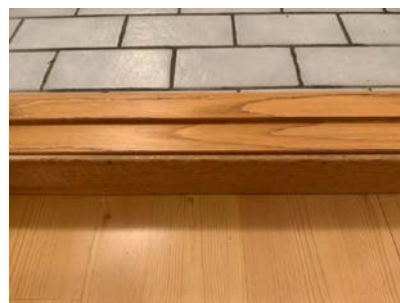
Feil type dørterskel på bad. På bad skal dørterskel være flat slik at det blir tilluftspalte under dørblad.
