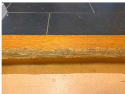
Stor slitasje på dørterskel på bad i hoved-etg.
