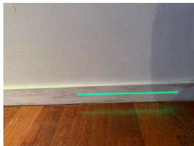
Bilder viser skjevheter i gulv i loftstue.
