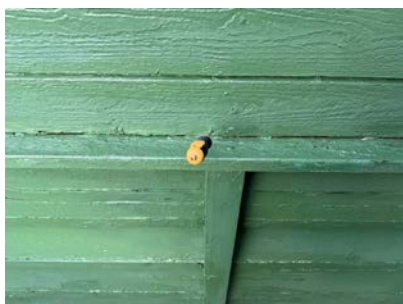
Råte i kledningsbord på levegg.
