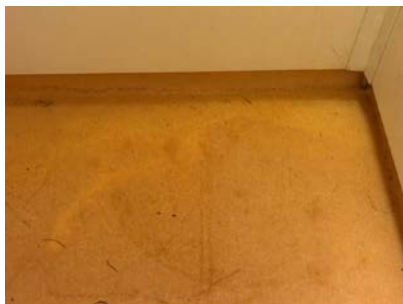
Misfarging i våtromsbelegg.
