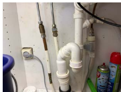
Rørøpplagg under vask.
