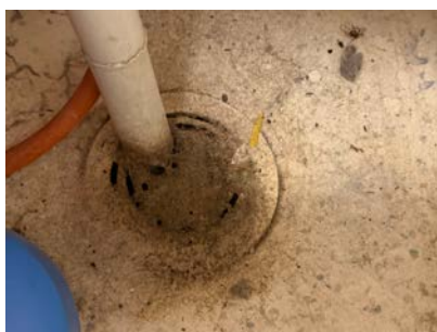
Eldre plastsluk i gulv.
