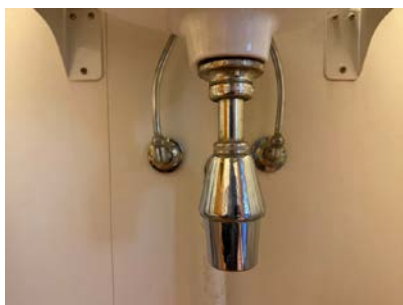
Rørøpplegg under servant.
