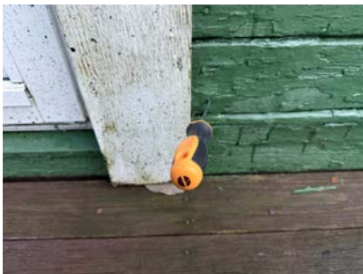
Råte i kledningsbord.
