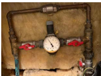
Stoppekraner på vaskerom.
