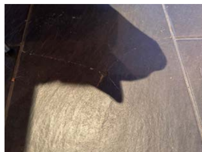
Sprekk i gulvflis.
