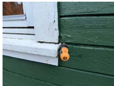
Råte i kledningsbord.
