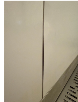
Fuktskader på baderoms plater i dusjsjonen
