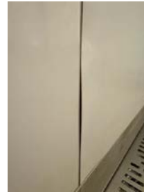
Fuktskader på baderoms plater i dusjsonen
