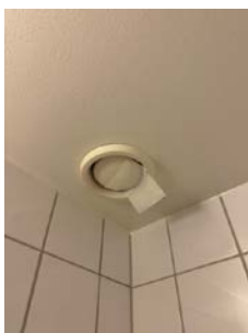
Test av avtrekk. Papiret henger.
